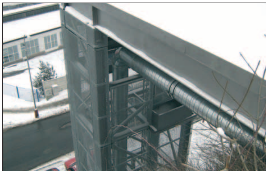
Obrázek č. 9: Detail věžovité konstrukce s teplovodem pod mladoboleslavským zámkem
