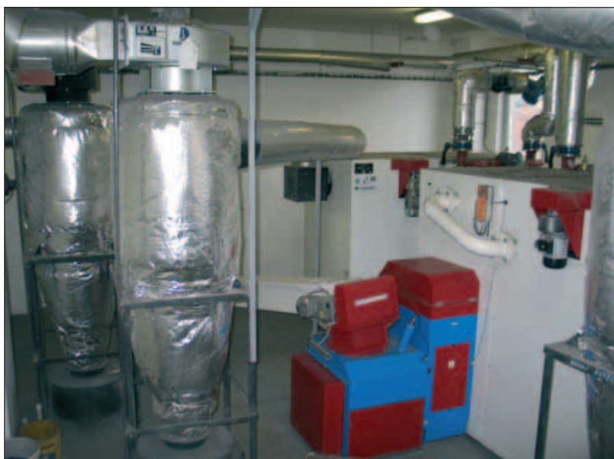
Obrázek č. 6: Tři kotle na biomasu dodávají teplo a teplou vodu téměř pro celé Měňany.
