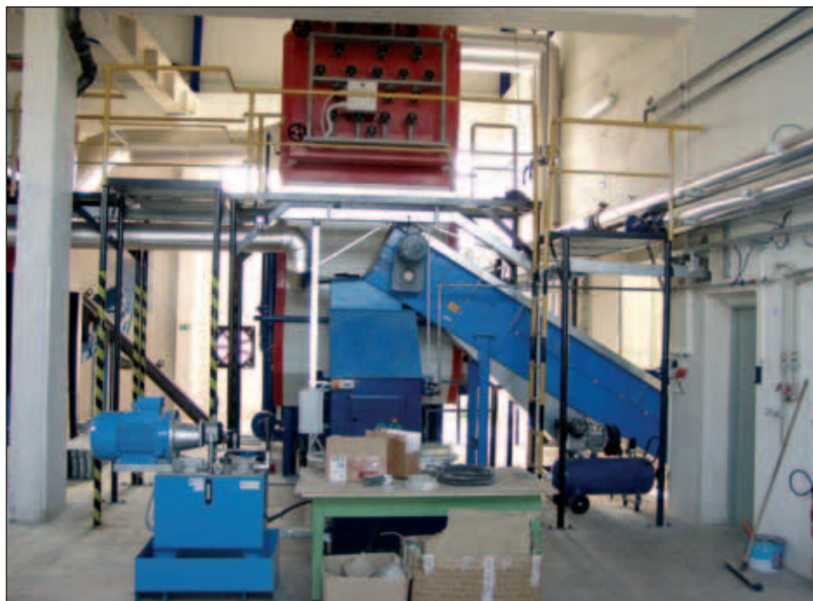
Obrázek č. 1: Kotel spalující biopalivo (dřevěnou štěpku) již v Novém Jičíně přispěl ke snížení ceny tepla pro domácnosti.
